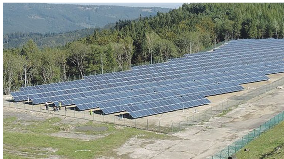
Elektrownia fotowoltaiczna na Górze Żar
